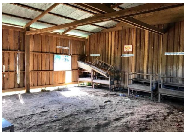
老朽化した校舎（2018年12月）
